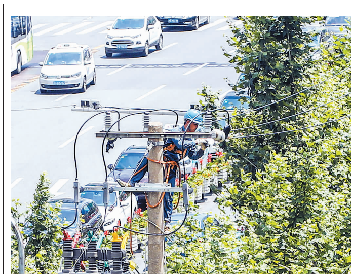
随着气温逐步升高,用电负荷不断攀升。在夏季高峰用电到来前夕,电力工作人员正在检查电路情况(如图),为电网安全度夏提供有力保障。
